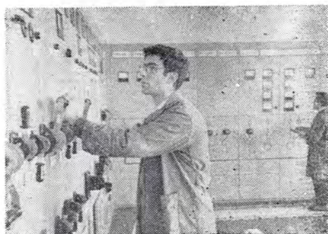
В командната кабина на електри- ческата подстанция № 1
